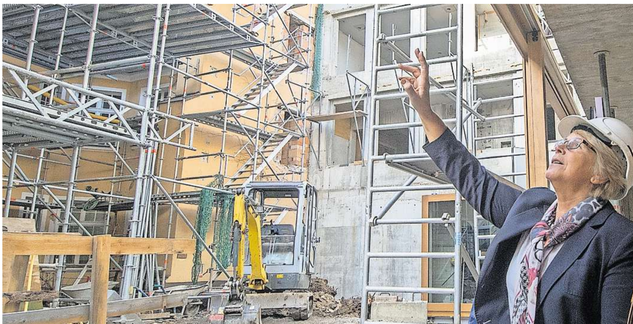
Ilse Danziger, Vorsitzende der jüdischen Gemeinde in Regensburg – hier in der Baustelle der neuen Synagoge, wird mit der Silbernen Bürgermedaille geehrt.
